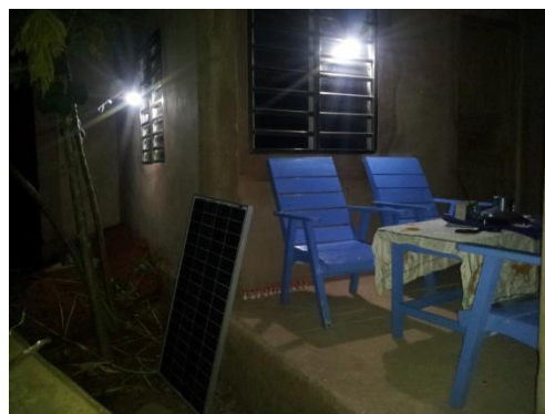
Panneau solaire et lampes
